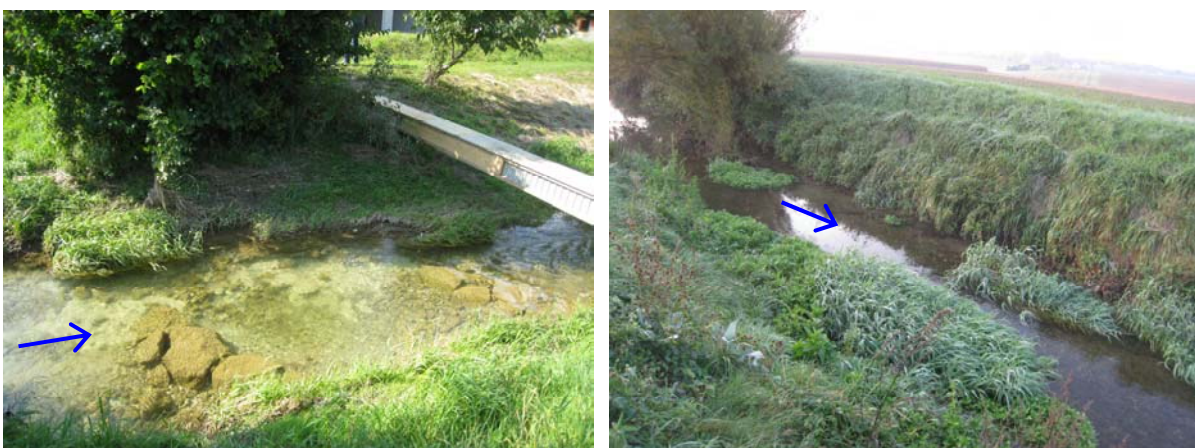
Abb. 4 Ufererosion gegenüber der zu schützenden Straßenböschung (links); Abschnitt mit Lenkbuhnen aus Fichtenspaltpfählen am linken Ufer gut ein Jahr nach Einbau (rechts)
